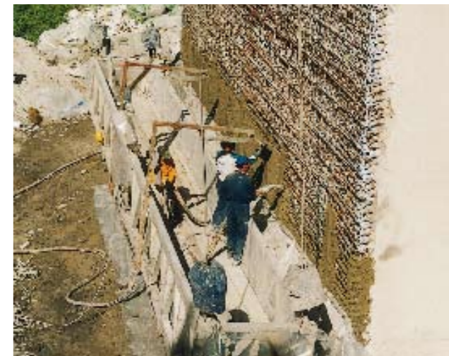
Queste pompe si adattano nel migliore dei modi anche ad applicazioni di grande entità, come nella fattispecie il risanamento del calcestruzzo di un ponte dell'autostrada in Italia.
