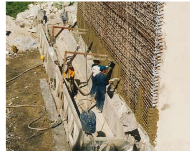
Ze zijn ook uiterst geschikt voor de grotere werven, zoals hier voor de betonrenovatie van een snelwegbrug in Italië.
